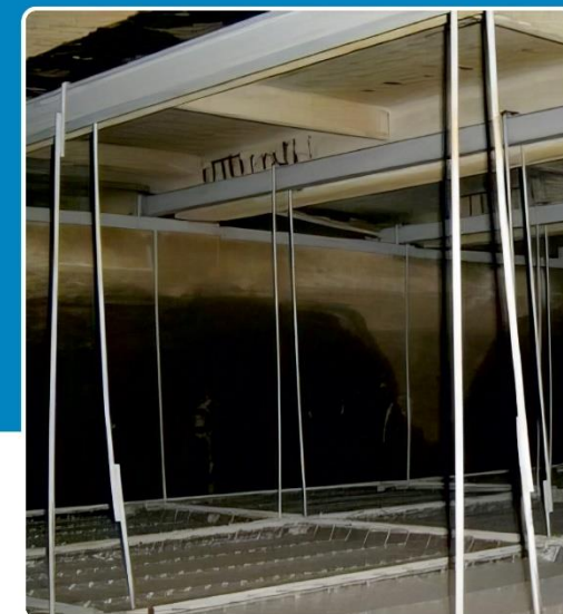
Тонкослойные модули из полиэтиленовой пленки, установленные методом подвешивания на опорные балки
